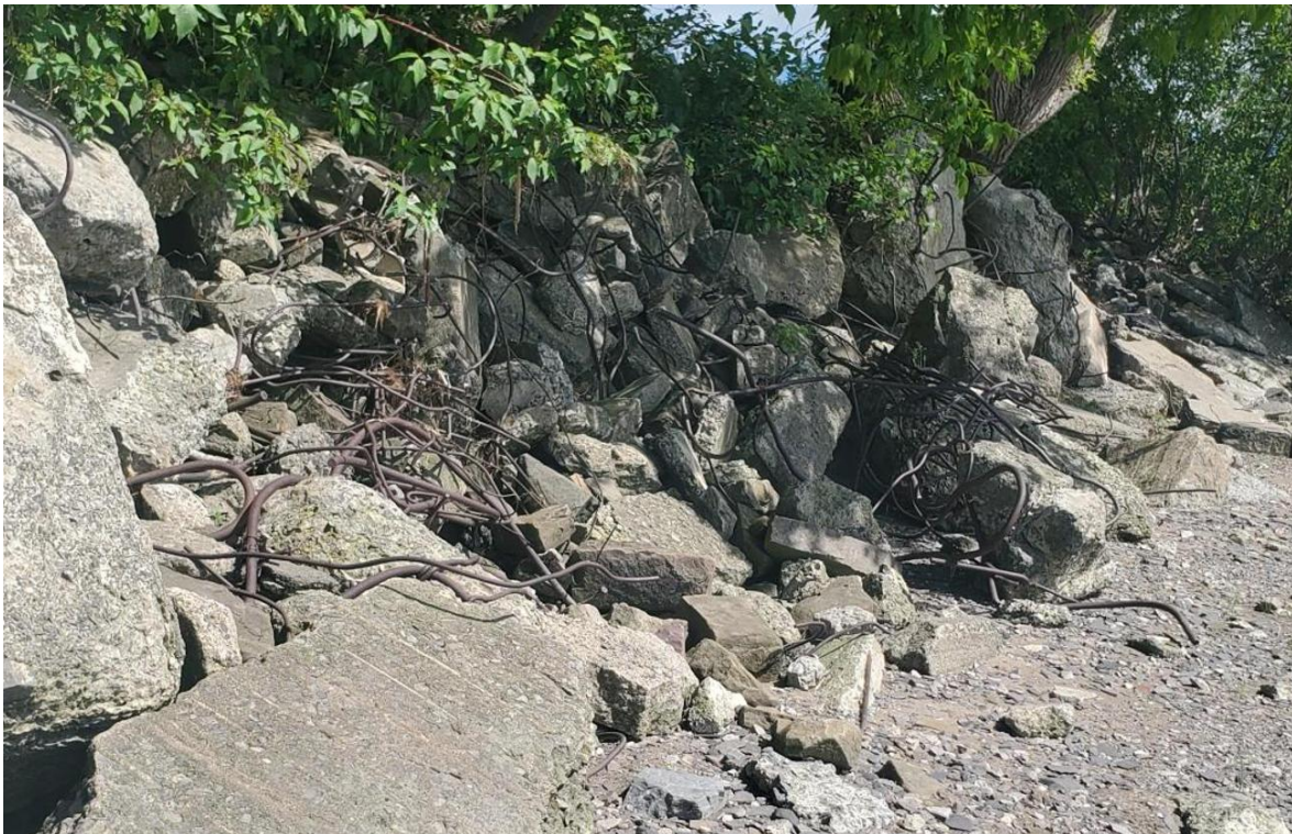
Figure 6. État du remblai de l'Espace Fillion.
